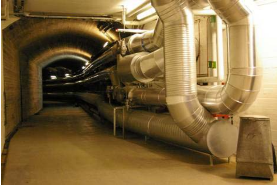
Eingangstunnel, mit Wärmeverteilungsleitungen
