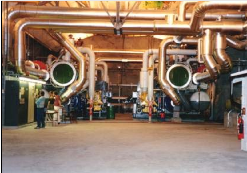
Maschinenraum, 2 Unitop® 28/28 mit Heißwasser - Verrohrung
