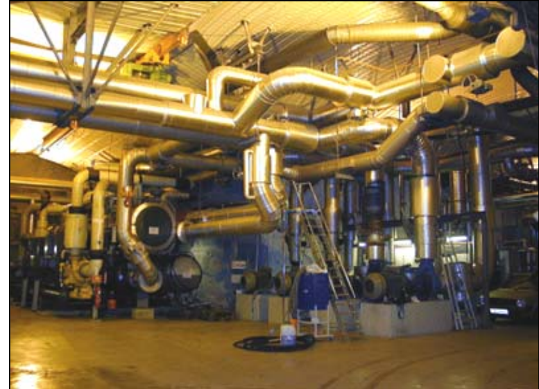
Maschinenraum, links: Unitop® 28/28, rechts: Wärme/Kälte Verteilpumpen
