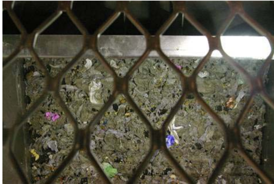
Abwasser - Filterstation Mechanische Filtration
