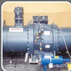
Fabrikgebäude (PL) Heizleistung: 233 kW Wärmequelle: Wasser
